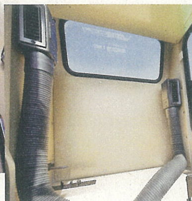
▲エアコンダクト
